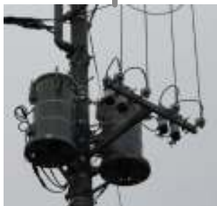
高岳製作所30KVA柱上トランス
